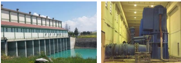
<그림5. 7500kVA MVD 펌프 스테이션 & 수직펌프>
