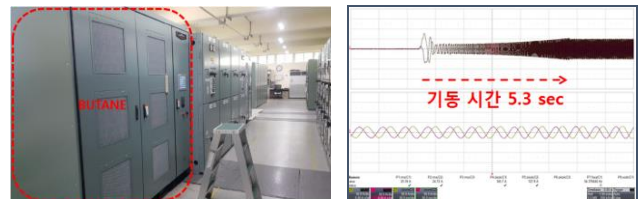
<그림4. 600kVA MVD & MVD output current.>
