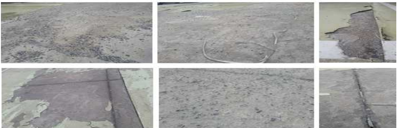
그림 1. 옥상 무근콘크리트 복합열화 (주차장 용도)
