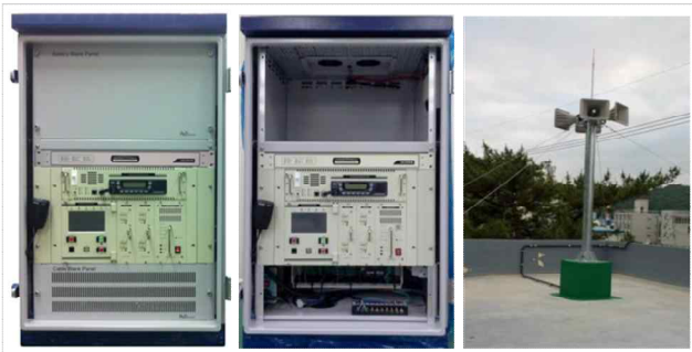
그림 5. 사이렌 타워(Siren Tower)
