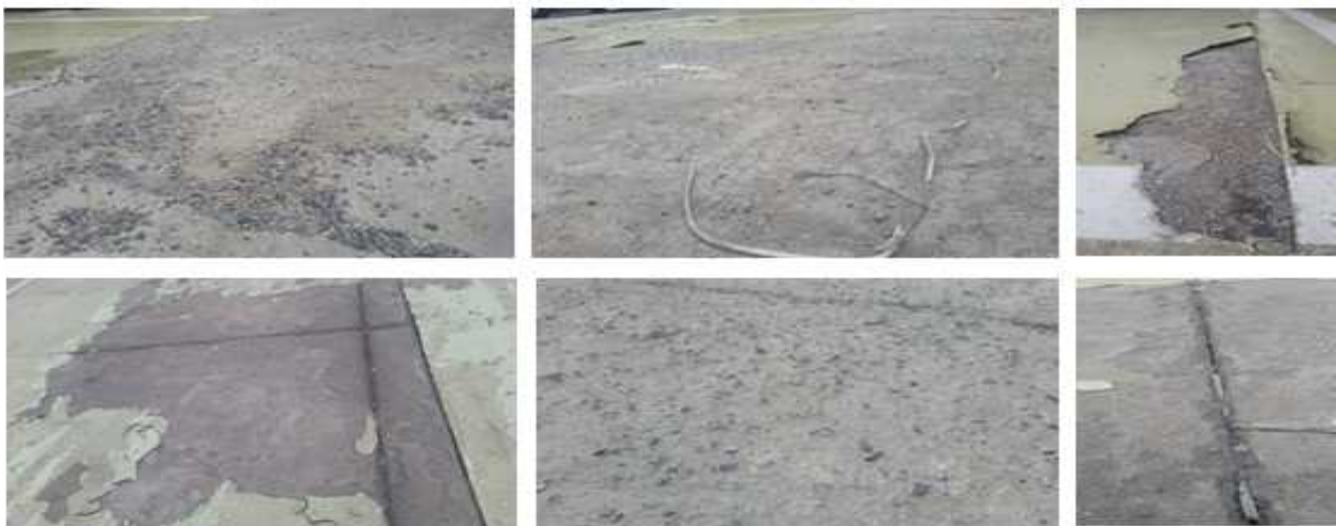
그림1. 옥상 무근콘크리트 복합열화 (주차장 용도)
