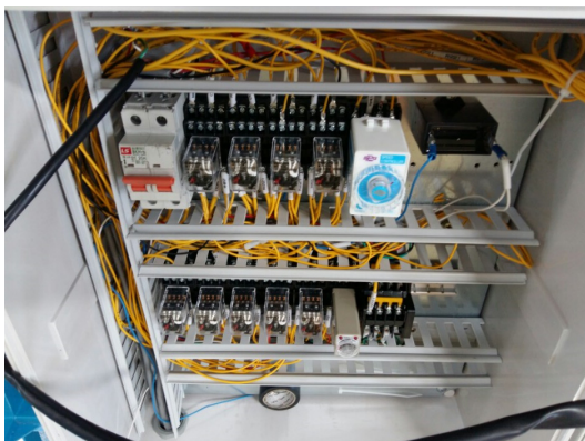
그림 4. 태양광에너지 Awning ON/OFF 박스 내부
