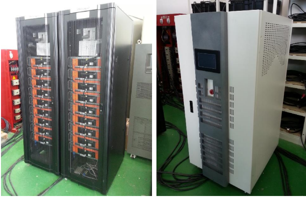
그림 3 리튬이온 축전지 랙 과 30kW급 PCS 시제품 Fig 3 Li-Ion battery rack and 30kW PCS prototype
