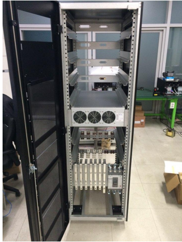
그림 3 200kVA 시스템 외형 Fig. 3 200kVA System appearance
