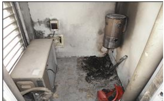
<그림 2> 건물 내부 소훼 사진
