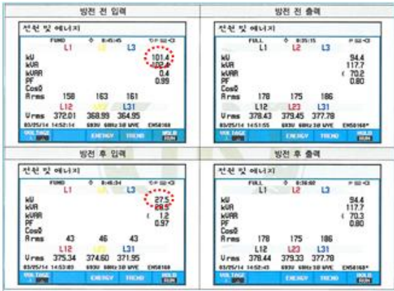
그림 3 ESS 동작 실험 Figure 3 ESS function test
