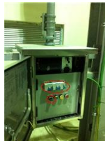
그림 2. DS Local Control Panel
