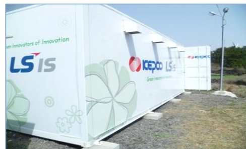
그림 2 STATCOM 실증 모습 Fig. 2 STATCOM Installation
