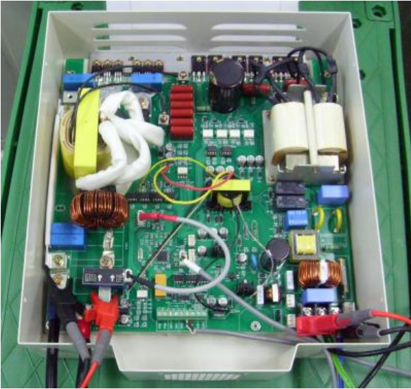
그림 2 연료전지용 전력변환장치 내부 Fig 2. Inside of Fuelcell Power Converter
