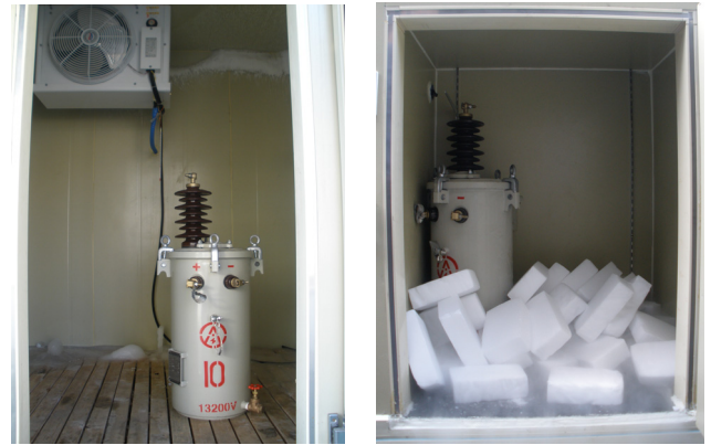
〈그림 1〉 냉동챔버 내의 변압기 및 운반용 냉동챔버 내의 변압기
