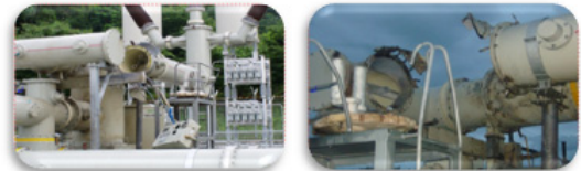
〈그림 2〉 170kV GIS DS 탱크 파열 고장사진
