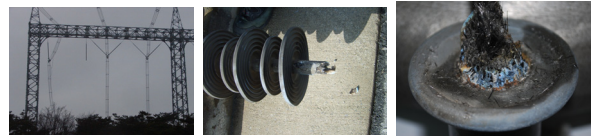
<그림 3> 765kV 폴리머애자 불량 사진
