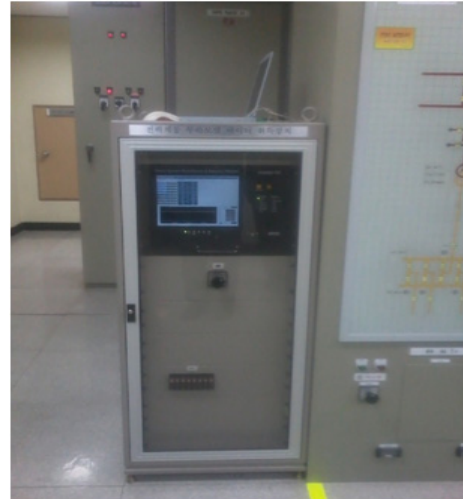
<그림 1> 고장기록계 설치
