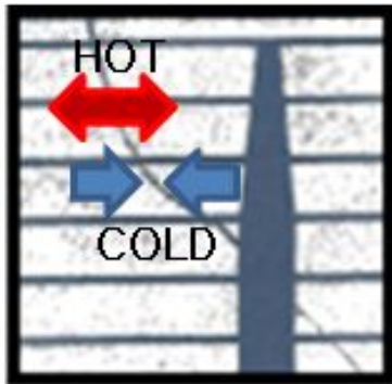
그림 2. 온도 변화에 따른 crack의 성장
