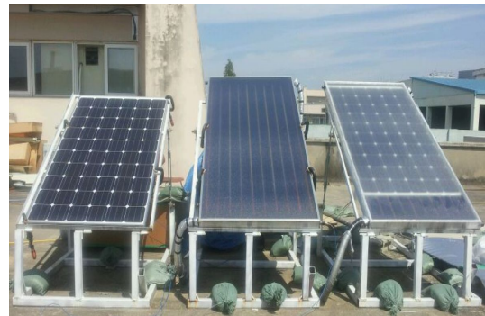
그림 3. PV-m(좌), STA-p(중), PVT-s(우) 설치사진
