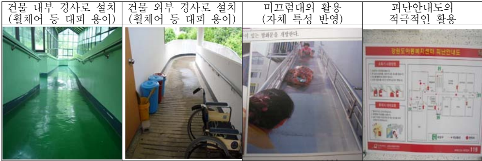
사진 1 사회복지시설의 특성에 맞게 설치된 피난기구
