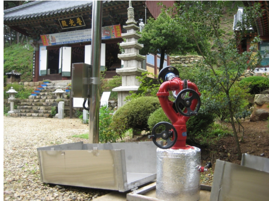
그림1. 방수총 앞 cctv 설치로 기능 불가 사례
