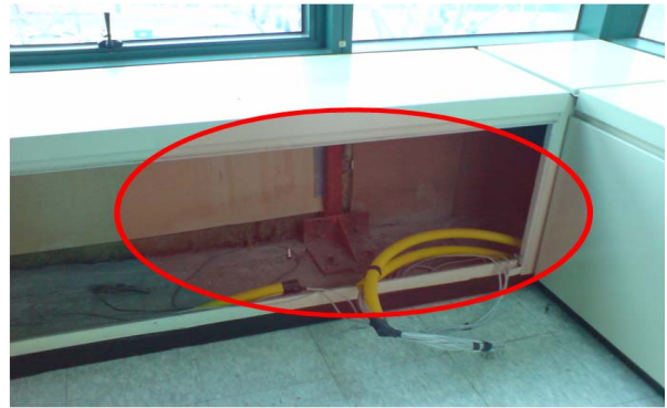
그림 4. 역삼동 N빌딩 4층 내부 앵커 유닛 및 프레임
