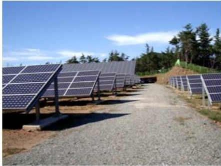
그림 2 당사 태양광 발전소(1.6MW) Fig. 2 Photovoltaic Power Plant(1.6MW)
