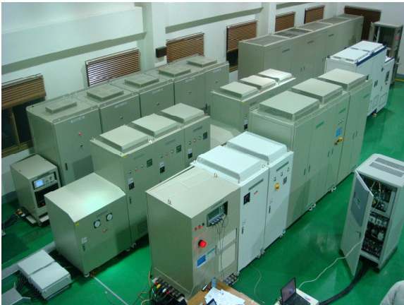
그림 2 태양광발전용 인버터 성능평가 시스템 사진 Fig. 2 Overview of test system for PV inverter
