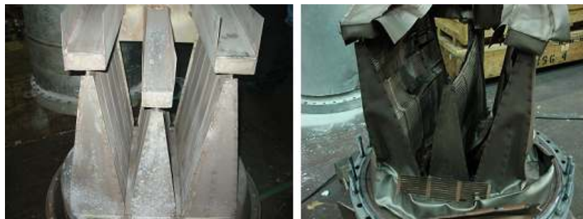
<그림 16> 정상 상태와 손상된 Filter 상태
