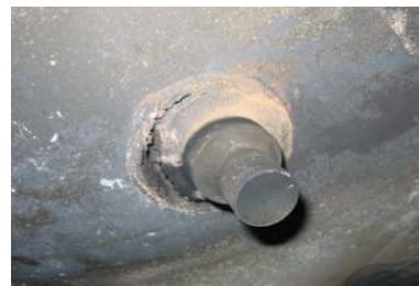
<그림 8> 외부 균열
