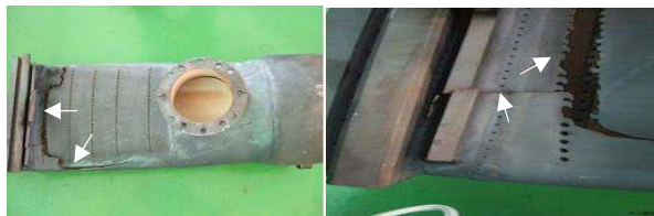
<그림 10> 연소기 균열 손상 상태
