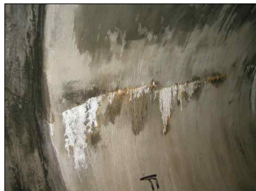
사진 2. 균열발생으로 인한 누수현상
