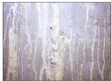
사진 3. 경화불량으로 인한 보수재 누출
