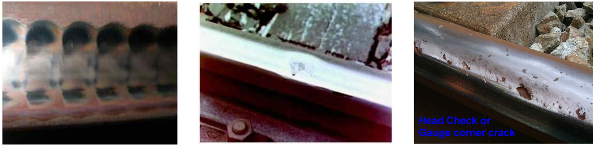
그림 1. 차륜과 레일의 인터페이스로 인한 결함(파상마모, 압좌, 표면박리)
