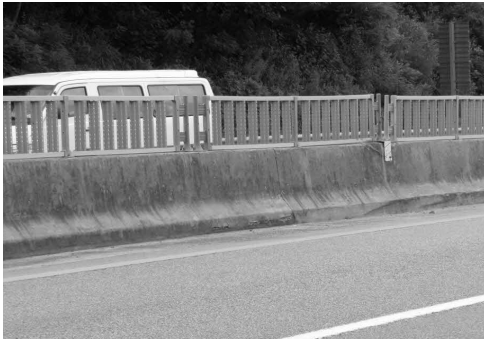
그림 1. 콘크리트 중앙분리대 표면바리
