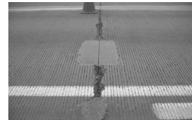
그림 3. 줄눈부 파손 및 부분단면보수
