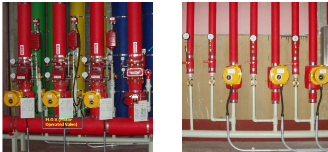
그림 1. Motor Operated Valve 설치상태
