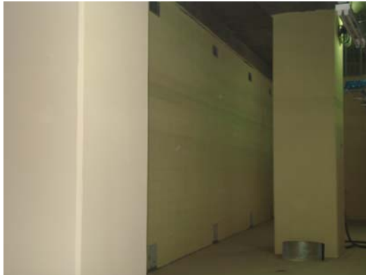
그림 2. 전기실 환기벽체 통기그릴 및 점검구
