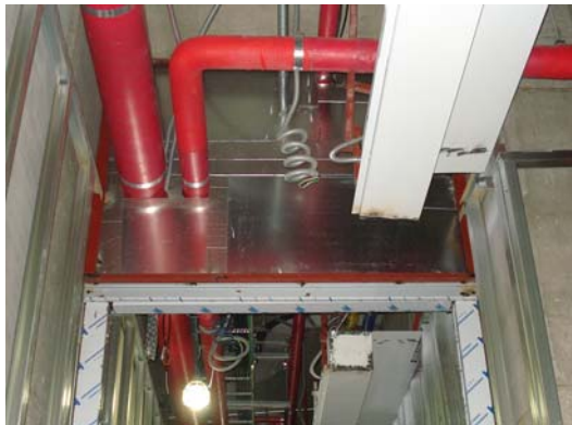
그림 5. 방화스크린의 천정 반자 내부 공간
