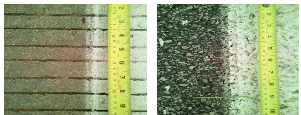
(a) 콘크리트 횡방향 30mm (b) 교량부 아스팔트
