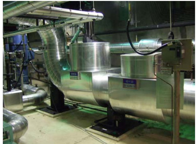
Fig. 1 원자력 발전소 2 차측 고온·고압 배관 사진.
