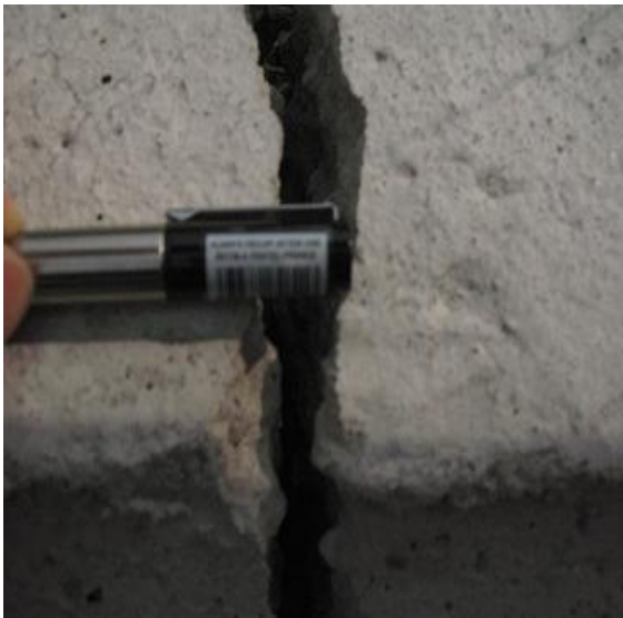
그림 5. 교대 Crack 발생
