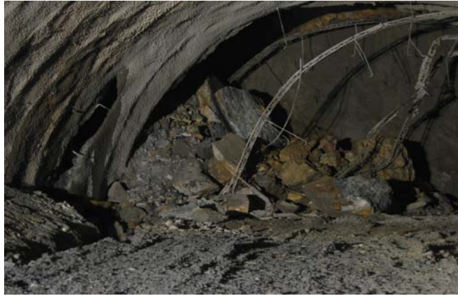
(a) 측벽부 과다변위로 인한 격자지보재 손상
