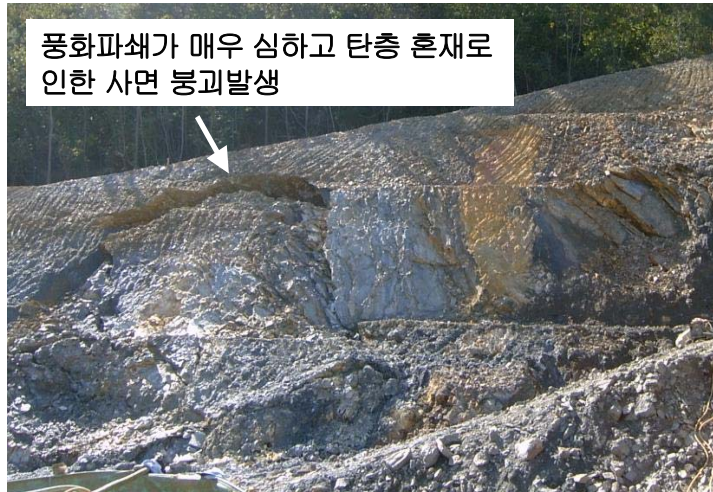
사진 2. 터널(하행선) 갱구부 사면 붕괴 사진
