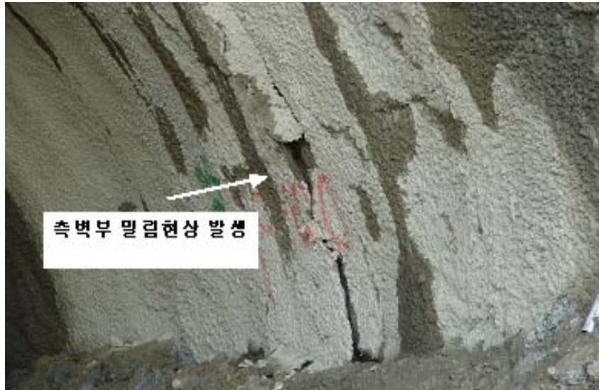
사진 5. 막장 후방부 측벽부 과다변위에 의한 균열발생(최대 60cm)
