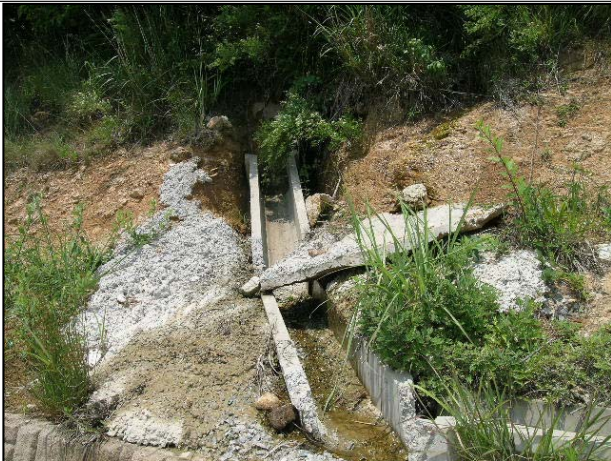
<사진3.2.2> 붕괴부 전경
