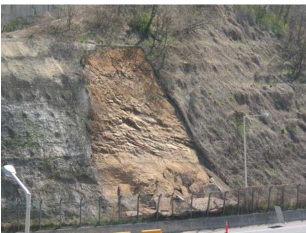
그림 9. 슛크리트 균열로 인한 붕락
