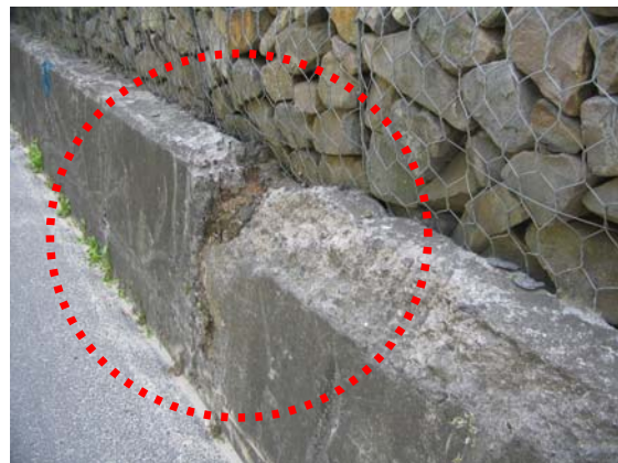
그림 17 돌망태옹벽 훼손에 의한 측구 손상
