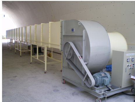
그림 3. 실험용 송풍기 및 덕트 전경
