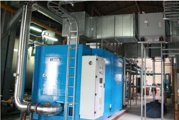
Fig. 4 실증사이트에 설치된 열병합발전시스템
