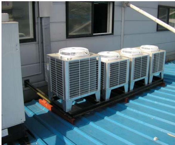
Fig.9 항온항습 실험실 A실, B실용 실외기 사진
