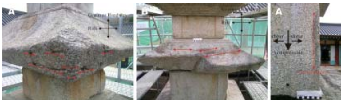
Fig. 6 선암사 동삼층석탑에서 나타나는 수직, 수평 균열의 발달 양상.
