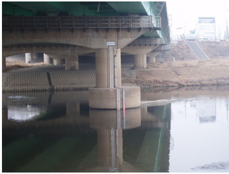
그림 7. 기초와 교각에 분리하여 설치한 LED 수위표
