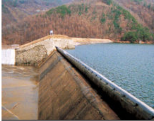
그림 4. 여수로에 설치된 가동보
