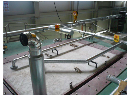
(a) HVAC Mock-up 천정 사진
