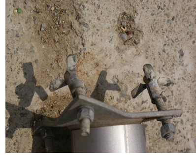
[그림 7]난간 고정부 파손(성구미)
