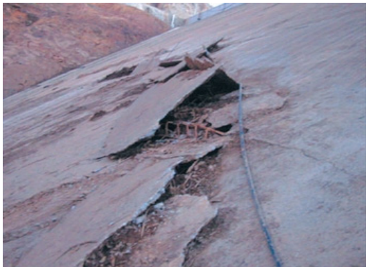
Abutment 부근의 파괴
