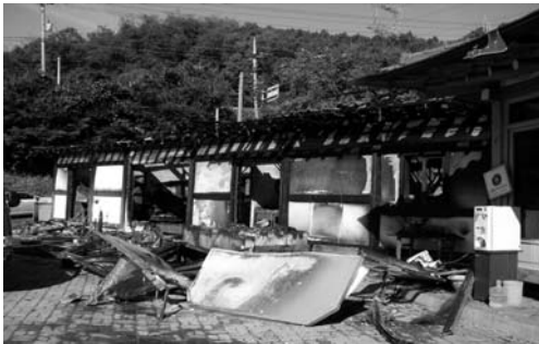
Fig. 7. 건물 1동 앞쪽 전소
