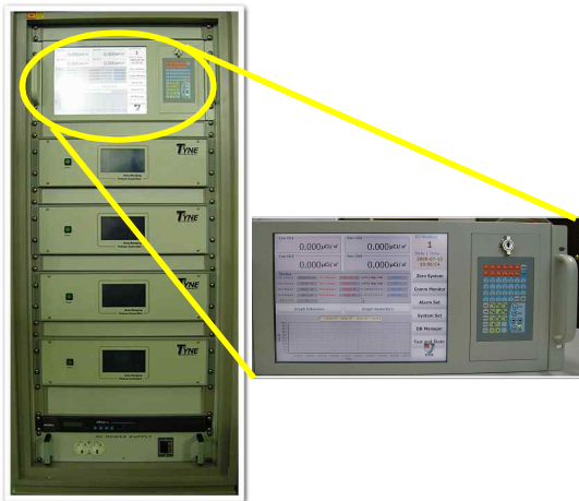
<그림 2> 삼중수소 실험실 입구에 설치된 TMC
