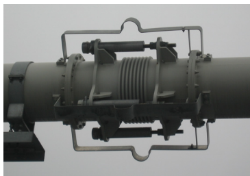
<그림 2> GIS에 설치된 벨로우즈
