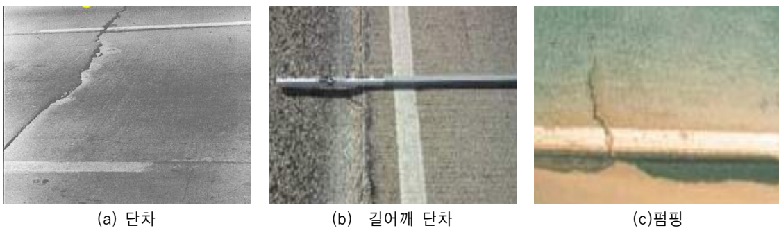
(a) 단차 (b) 길어깨 단차 (c)뽀뽀 <그림 6> 변형 형태(FHWA, 2003, Distress Identification Manual)
